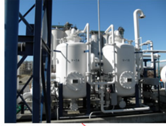
VOC回収設備
