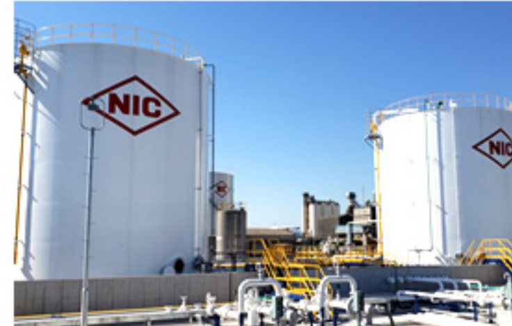
909タンク 908タンク
