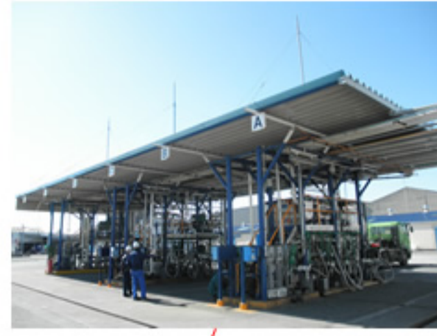
ローリー充填場
