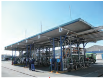
ローリー充填場
