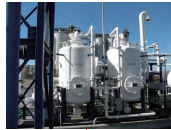
VOC回収設備
