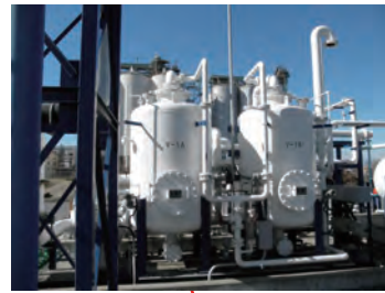
VOC回収設備
