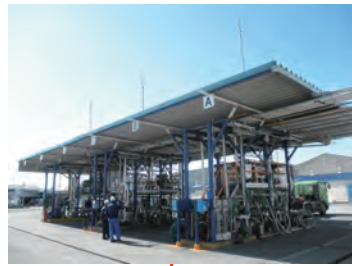
ローリー充填場
